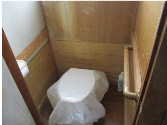
トイレ (大便器)
