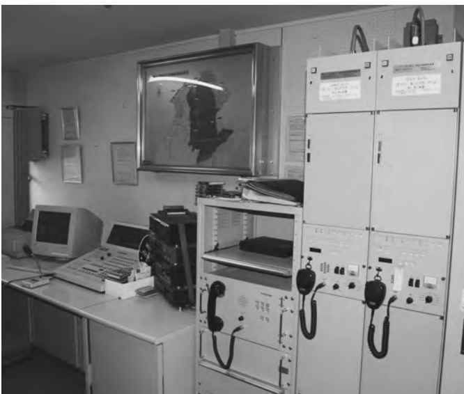
防災行政無線親局 防災無線整備事業債(債とは借金のこと)を利用して設備入れ替えをします。
