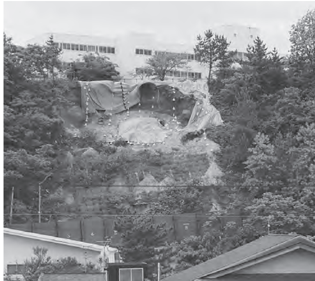
昨年の10月16日、大雨が原因で崩落した西海小学校下斜面は、今年2月11日再び崩落。現在、復旧工事が進められています
