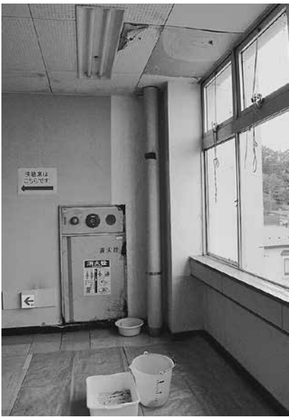
庁舎3階廊下、天井からの雨漏り箇所
