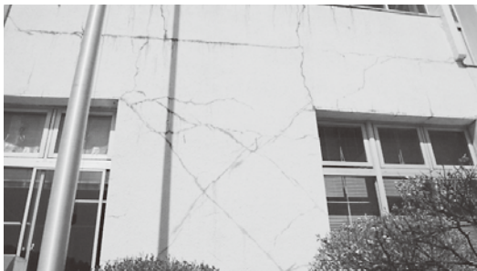
日本海中部地震により発生した亀裂
