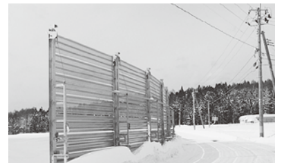
道路整備交付金事業により設置された防雪柵（長平地区）
