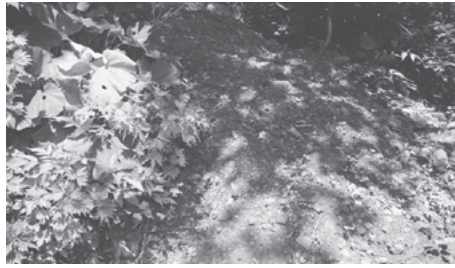
遊歩道入口付近の法面崩落箇所
