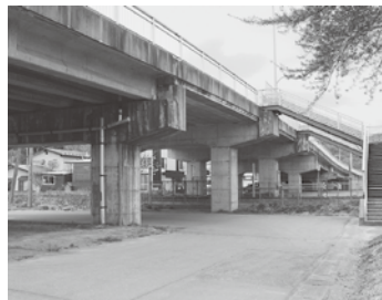
写真：耐震補強が必要な鯉ヶ沢跨線橋
