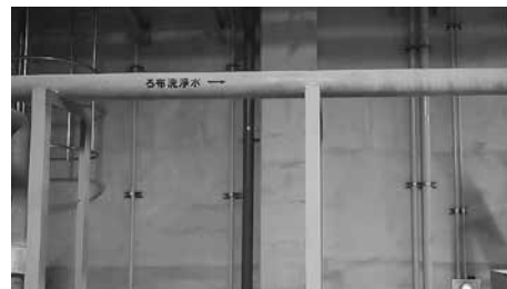
泥の跡が残る地下室天井付近
