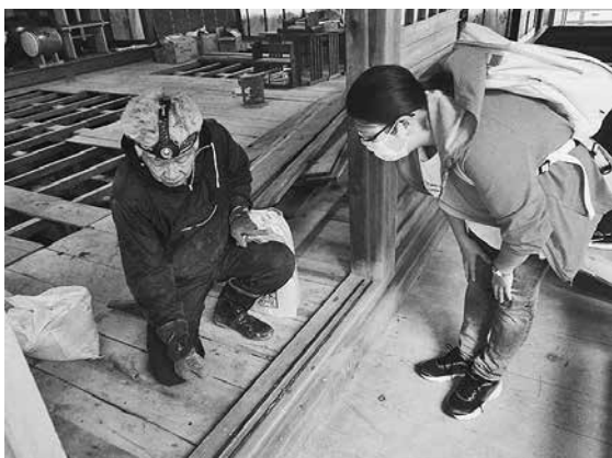
資料ネットによる災害後の現地調査（正八幡宮）
