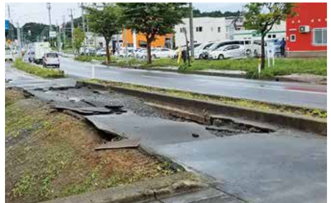
水が引いた国道101号バイパス（8月10日）
