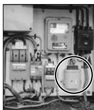
分電盤内の 低圧コンデンサー
